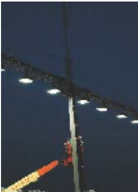
가로등에 설치된 안테나
